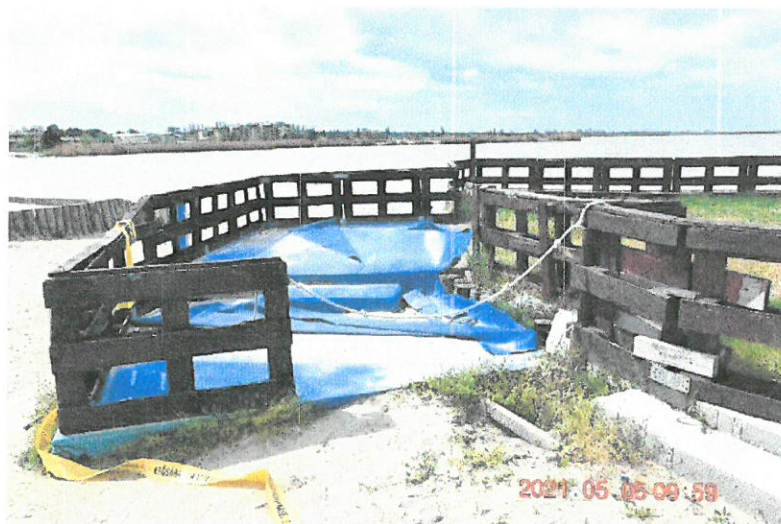
A tómederhez vezető külső lejárathál a munkák befejezetlenek.
